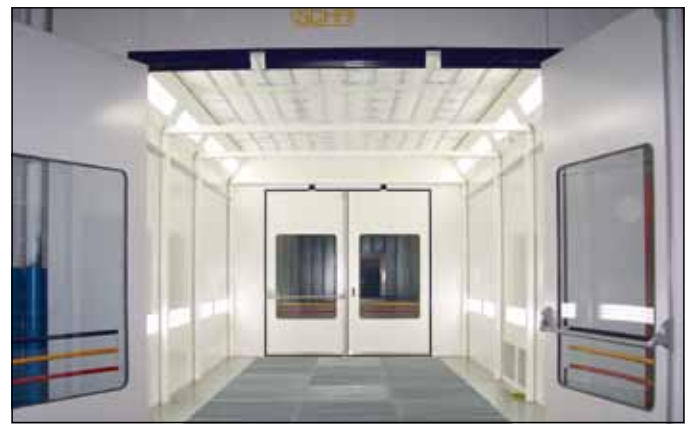
Speciale installatie GBA – ondergrondse afzuiging
